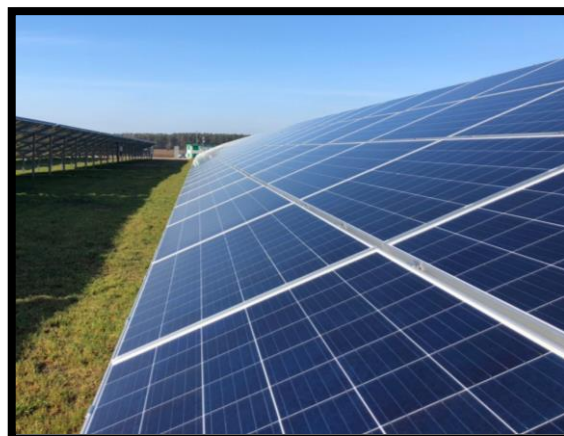
Zdj. 2 Polikrystaliczne panele fotowoltaiczne
