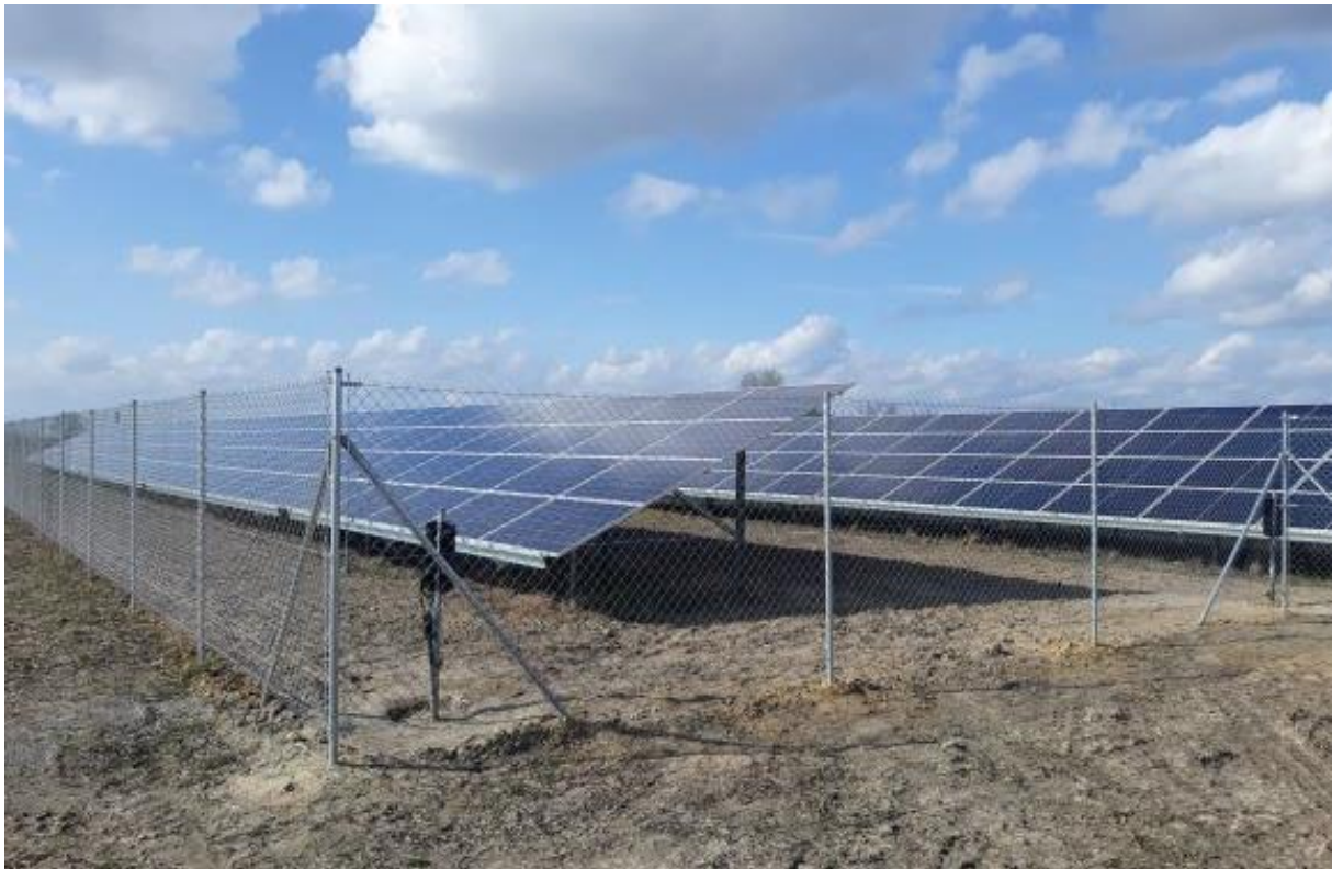
Rycina 8. Przykładowe ogrodzenie farmy fotowoltaicznej.
