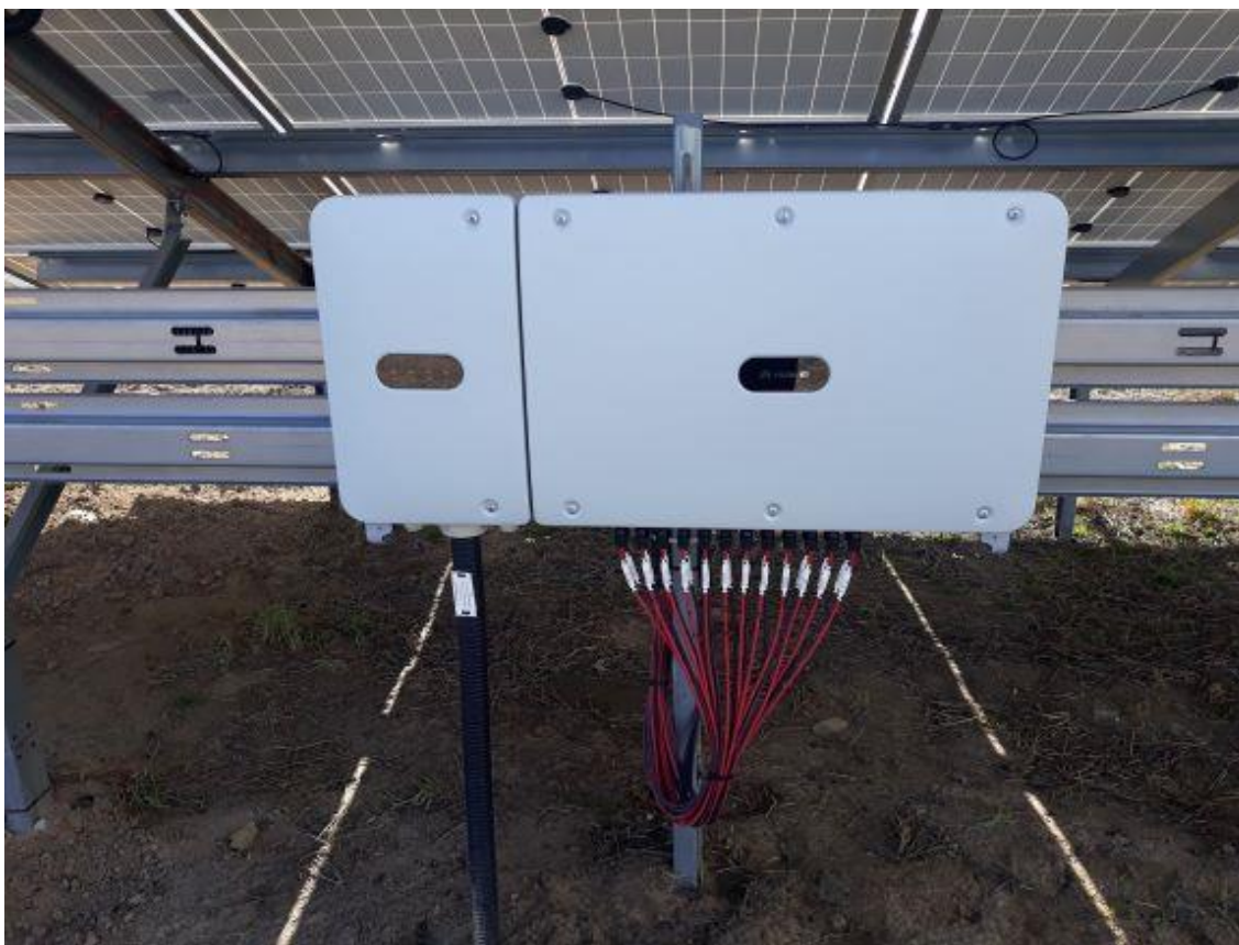
Rycina 6. Przykładowy inwerter farmy fotowoltaicznej.
