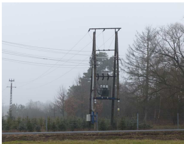
Zdj.14. Słupowa stacja transformatorowa w bezpośrednim sąsiedztwie ul. Spacerowej.
