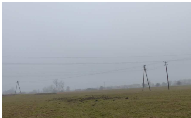
Zdj.15. Linie elektroenergetyczne 15kV.
